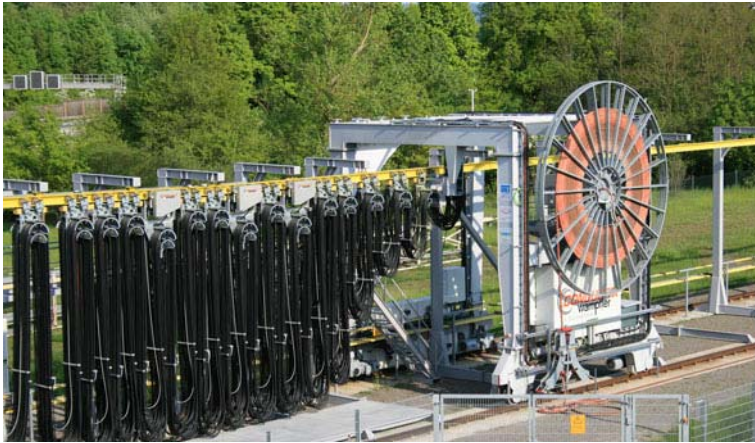
BU: Testanlage V-Rex 300 auf dem Gelände der Conductix-Wampfler AG in Weil am Rhein
