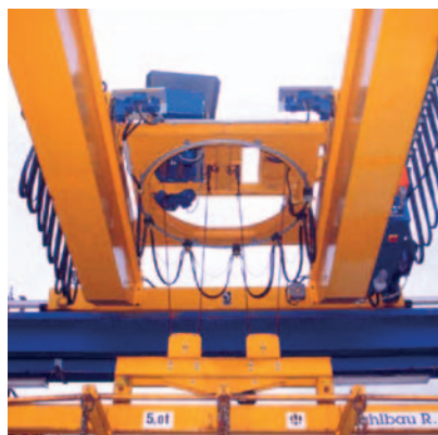
Napájení otočné kočky mostového jeřábu
