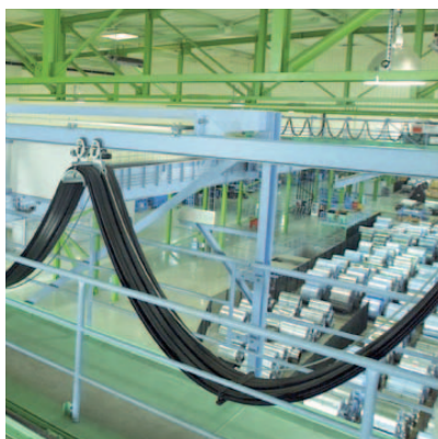
Přenos dat a energie na jeřábu v ocelárně
