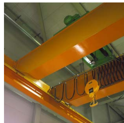
Napájení jeřábové kočky na mostovém jeřábu
