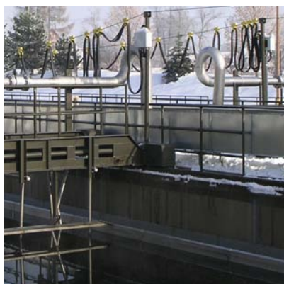
Napájení mostu v ČOV pomocí kabelové vlečky
