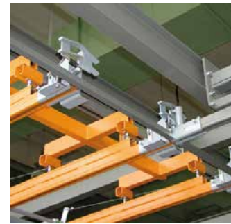
Ponts à déplacement latéral pour le transport transversal destiné à l'alimentation de dérivations dans un secteur de laquage et de séchage
